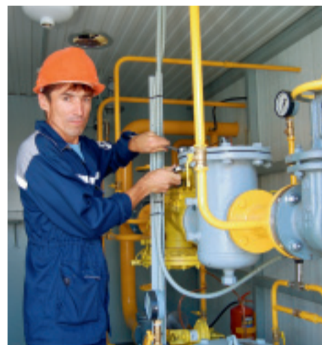
Слесарь Ильнур Давлетов осуществляет проверку оборудования нового блочного газорегуляторного пункта (с. Киргиз-Мияки).
