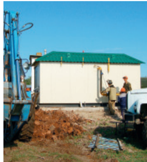
В селе Киргиз-Мияки силами районной эксплуатационной службы филиала «Стерлитамакгаз» введен в строй новый блочный газорегуляторный пункт.
