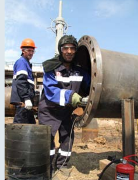
Работы на газопроводе ТЭЦ 1, 2 ведут слесарь СГС Ильшат Чурагулов и газозлектросварщик Мавлетян Шайхиринов
