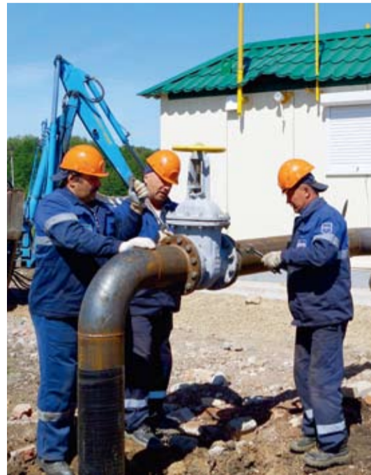
Слесари СЭРГО Николай Артамкин, Валерий Герасимов, Алик Ишмуратов устанавливают задвижку d200 на входе газопровода высокого давления.
