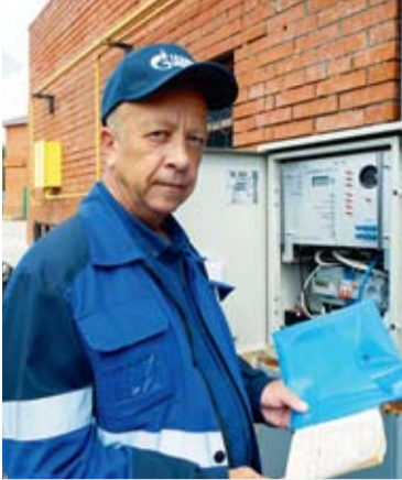
Сергей Агибалов проводит контроль технического обслуживания катодной станции.
