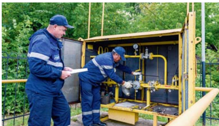
Мастер СГС Руслан Камалиев и слесарь ЭРГО Раиль Маматов выполняют техническое обслуживание газового оборудования ГРШП.
