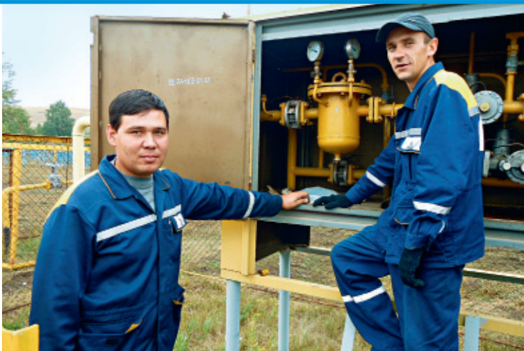
Мастер УГС Азамат Юнусбаев и слесарь СПГ Сергей Пермяков на техническом обслуживании ШРП
