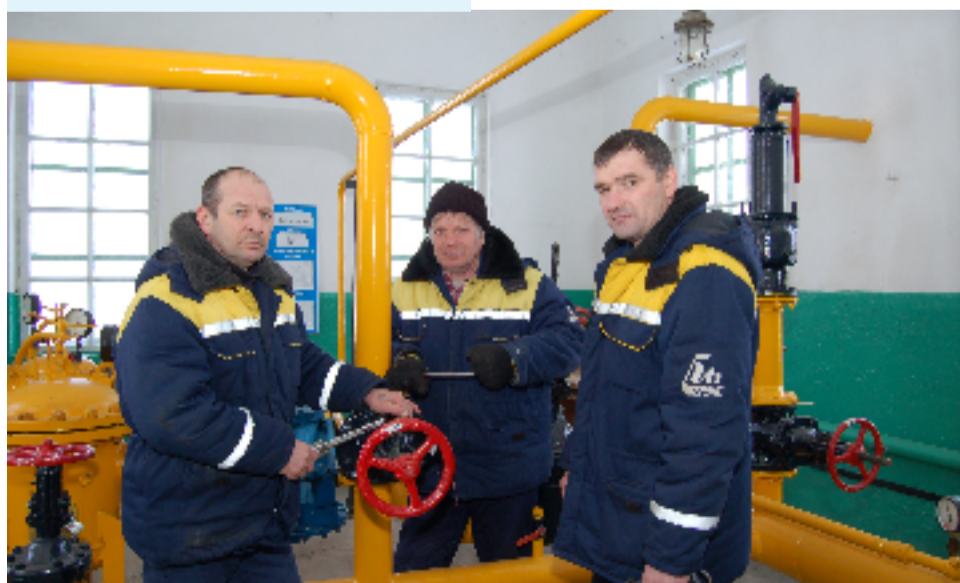
Слесари Рамил Хазмеев, Павел Селиверстов и мастер Ильдус Габбасов проверяют работу оборудования головного ГРП
