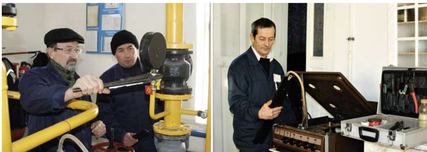
Слесарь ЭРГО Сергей Махмудов и водитель Рамиль Бижмухаметов проверяют работу оборудования ГРП
