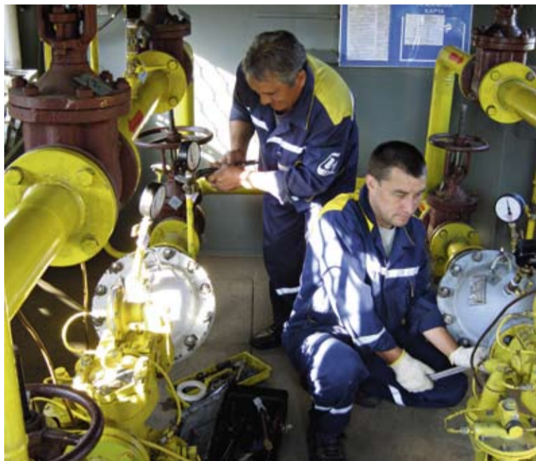
Слесари Р.Р. Маматов и А.Ю. Пилипеко осуществляют техническое обслуживание газового оборудования ГРП
