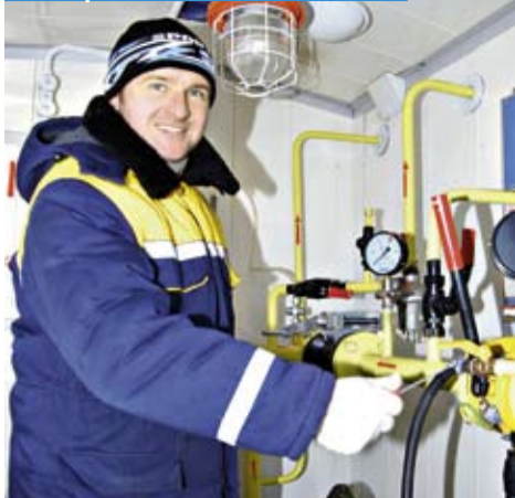
Слесарь ЭРПГ «Кумертаугаз» Николай Феоктистов проверяет оборудование ПГБ в Ямансарово
